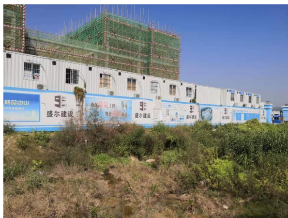
图 2 SQ040411 地块南侧边坡现状
